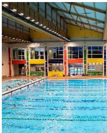
Iluminación de piscina cubierta
